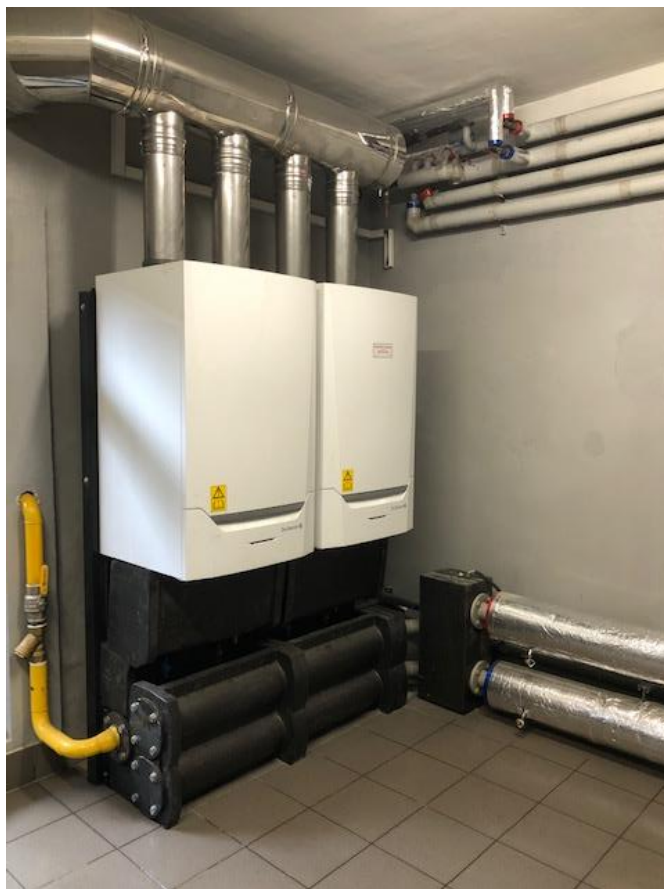
Kotłownia gazowa w SOSz-W w Działoszynie
